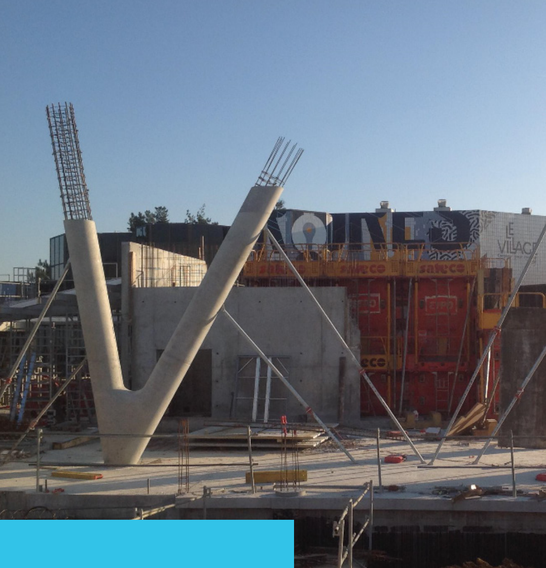
Campus Crédit Agricole Nantes
