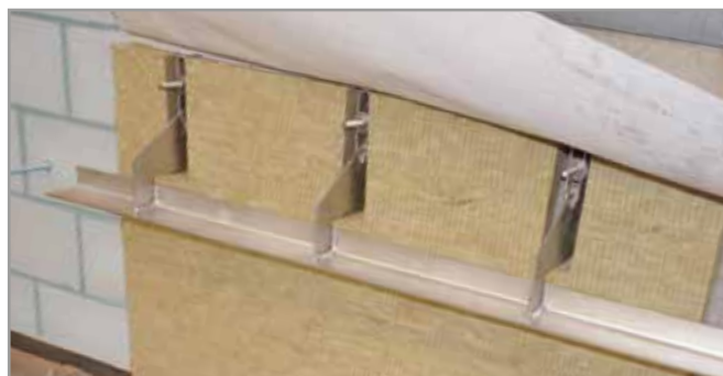
Résultat du placement du Korbo Dry au dessus du support de maçonnerie Korbo et de l'isolation.
